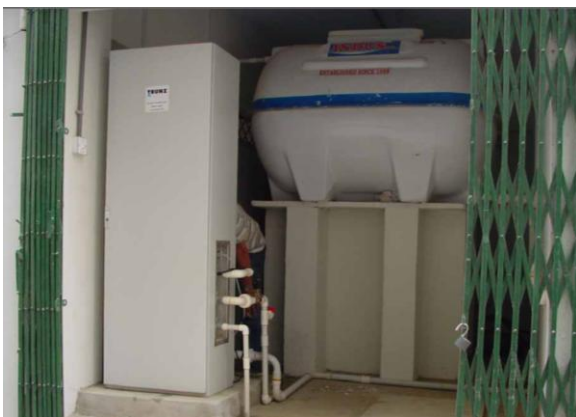
Trunz Water Unit 100 in einem Wohnhaus in Karachi, Pakistan
